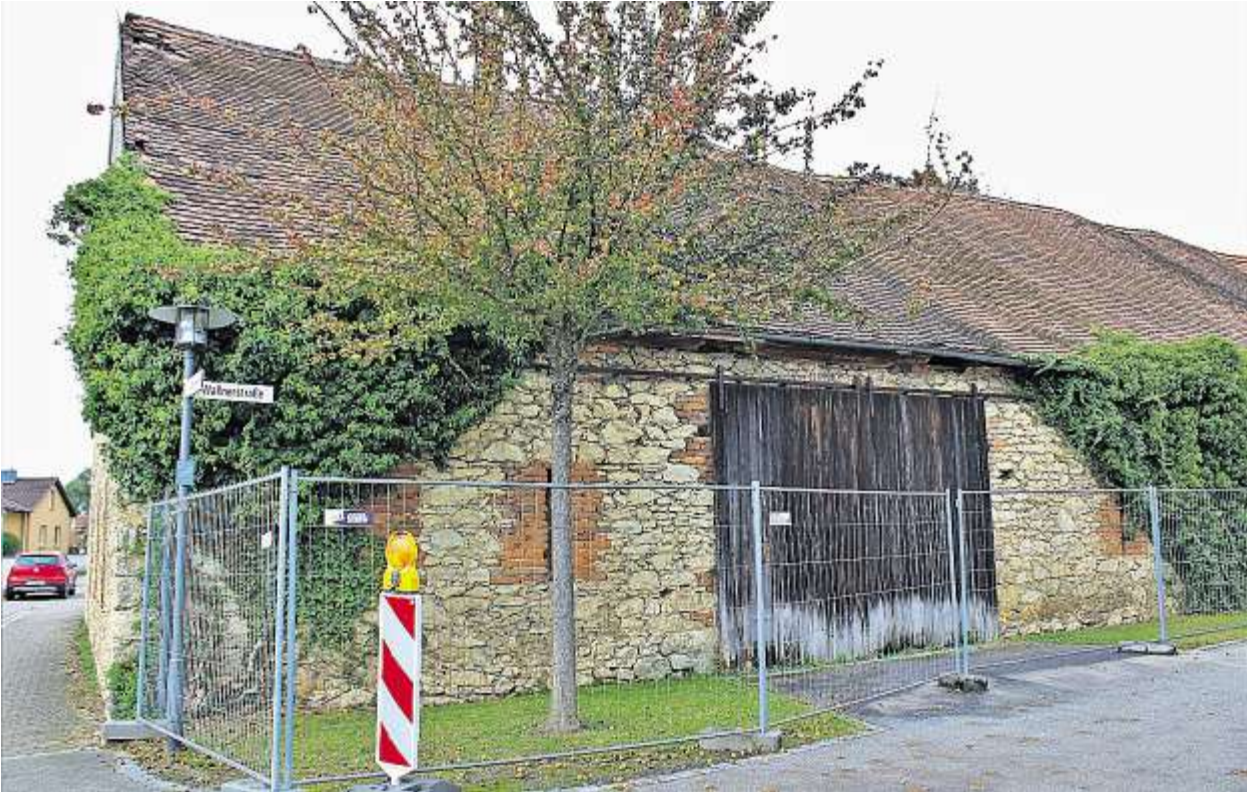
Die Mauern sind nicht mehr standsicher und das Dach ist marode.
